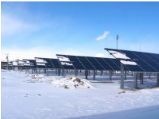
【コープ・市民ソーラーとかち南町発電所】
