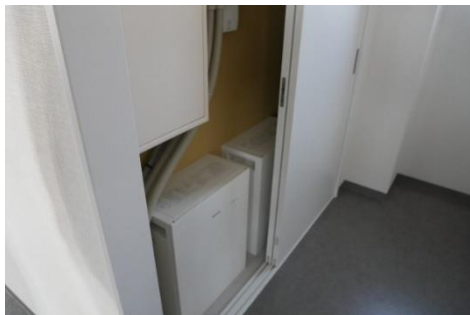
3階に設置された蓄電池
